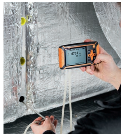
Измерение с помощью трубки Пито в воздуховоде
