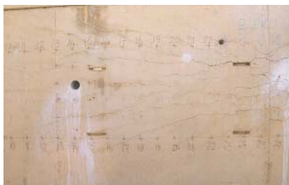
Рис. 1. Участок монолитной железобетонной стены в эпицентре ударного воздействия взрывной волны
