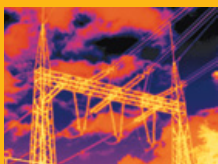
Проверка высоковольтных линий электропередач
