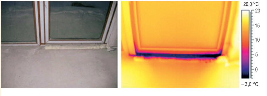
Рис. 4. Порог двери является «мостиком холода»
