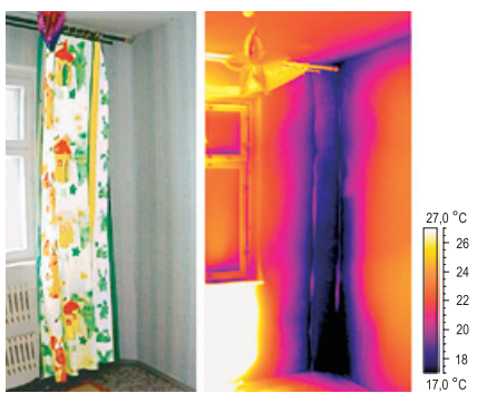
Рис. 1. Тепловизор: информация о дефектах при тепловизионной съемке внешних стен в помещениях: вни-зу углового стыка температура на 10 °С ниже температуры воздуха
