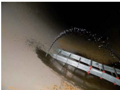
Рис. 2. Выход воды из водозаполненной полости через контрольное отверстие в металлической облицовке сталежелезобетонного водовода Саяно-Шушенской ГЭС
