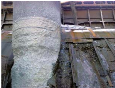
Рис. 5. Срыв металлической облицовки водослива (головное сооружение Дзауджикауской ГЭС каскада Северо-Осетинских ГЭС)
