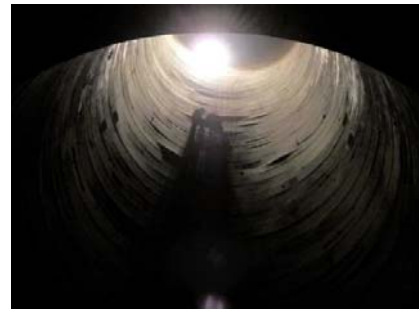
Рис. 6. Вдутье металла над замороженными полостями облицовки водовода Саяно-Шушенской ГЭС
