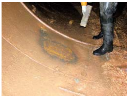
Рис. 7. Локальное выпучивание участка трубопровода из-за промерзания воды, скопившейся в заоблицовочной полости (трубопровод осушен и остановлен в зимнее время для ремонта оборудования)
