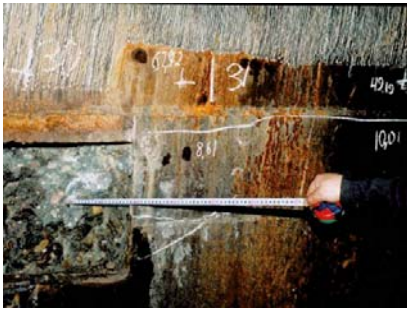
Рис. 3. Каверна глубиной до 200 мм в штрабном бетоне за оторванной облицовкой сопрягающего пояса камеры рабочего колеса гидроагрегата с облицовкой опорного конуса
