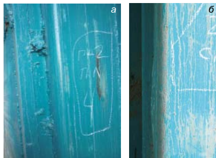
Рис. 8. Металл пазовой конструкции: а — следы затиров выпуклых участков металлического покрытия скользящими деталями затвора; б — выпучивание облицовки пазовой конструкции затвора
