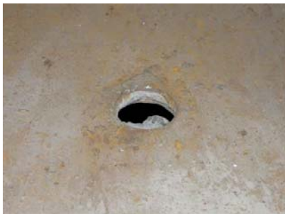
Рис. 1. Водовод Саяно-Шушенской ГЭС. Одна из заоблицовочных полостей, не зацементированная в строительный период (объем инъецированного раствора более 1 м³)
