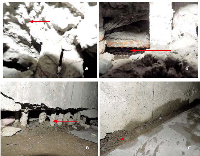
Рис. 2. Результаты визуального контроля стен: а — участки неудовлетворительного затвердевания бетона (с раковинами); б — пустоты в основании южной стены; в — обнаженная арматура; г — раковинчатая структура бетона в основании южной стены
