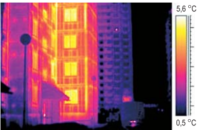
Рис. 7. Дефекты угловых стыков панелей на 1, 2 и 4 этажах
