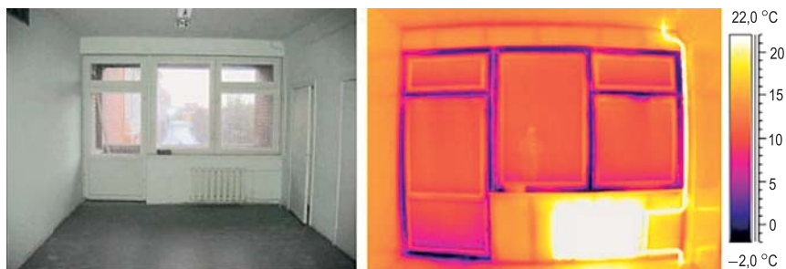
Рис. 3. Инфильтрация через неплотное примыкание створок окна и балконной двери
