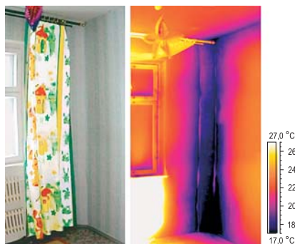
Рис. 1. Информация о дефектах при тепловизионной съемке внешних стен в помещениях: внизу углового стыка температура на 10 °С ниже температуры воздуха
