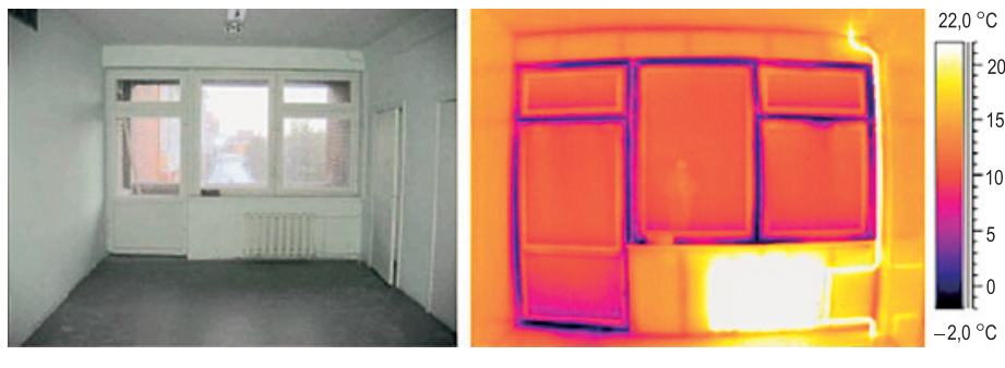
Рис. 3. Инфильтрация через неплотное примыкание створок окна и балконной двери
