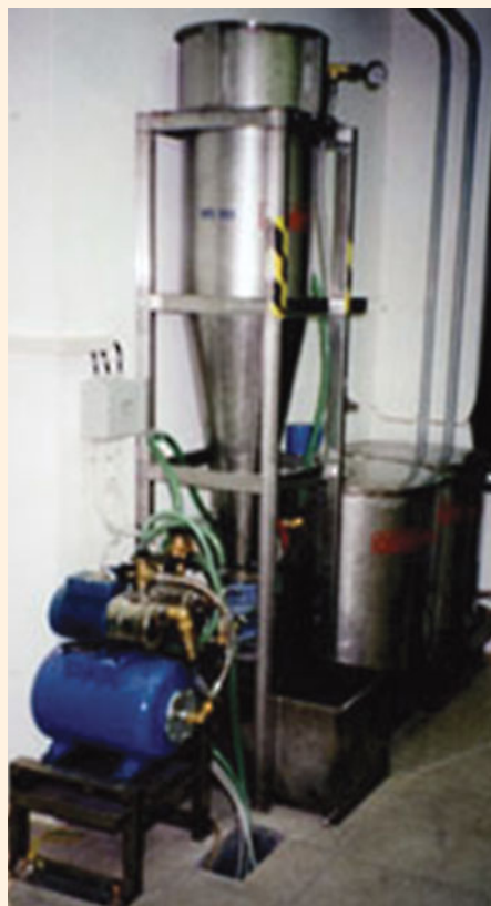
Рис. 9. Система очистки стоков линии
