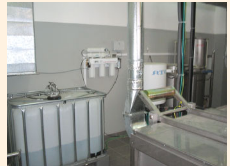
Рис. 8. Фрагмент линии, установка осмотической фильтрации промывочной воды
